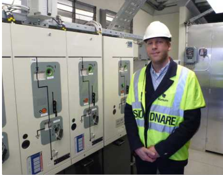
欧洲工业企业配电开闭所
